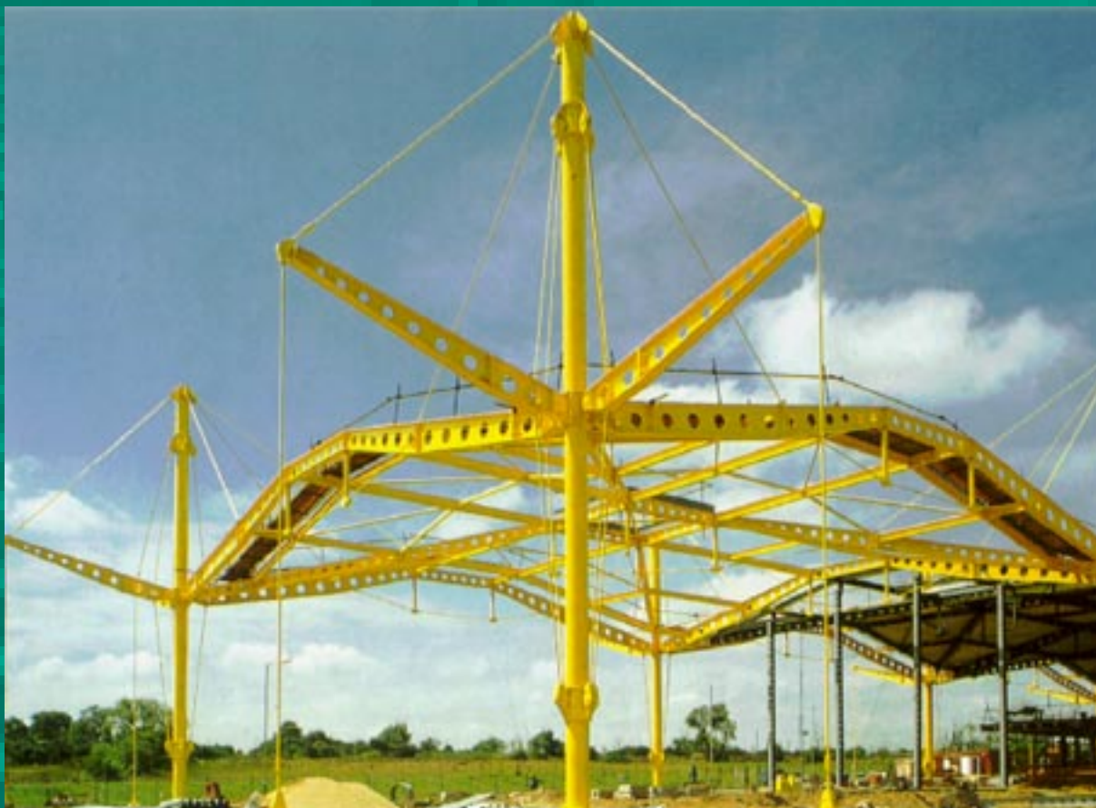
Norman Foster Associates, Centre Renault a Swindon , 1983. Vista della struttura strallata durante la costruzione dell'edificio. (da: Ian Lambot, ed., Norman Foster, Foster Associates. Buildings and Projects 1971-1978 , Watermark, Hong Kong, 1989, p. 217).
