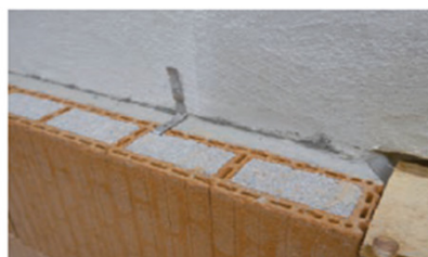
Realizzazione dell'ancoraggio della controparete alla parete esistente ogni 3 corsi in altezza a distanza orizzontale di 1,5 m*
