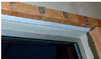
Realizzazione architravatura classica con fondello in laterizio di lunghezza adeguata e isolante interposto
