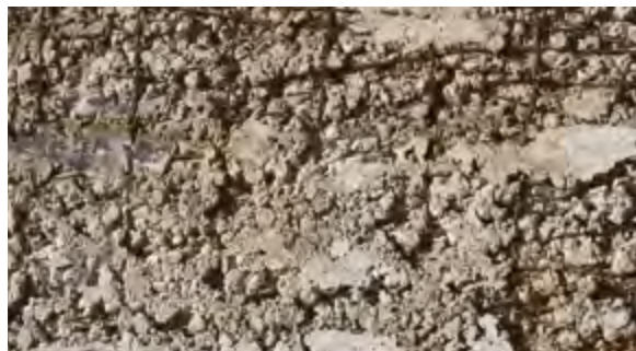
Esempio di segregazione degli aggregati nel calcestruzzo.
