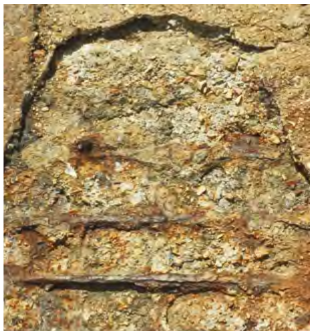
Esempio di corrosione dovuta all'attacco da cloruri.
