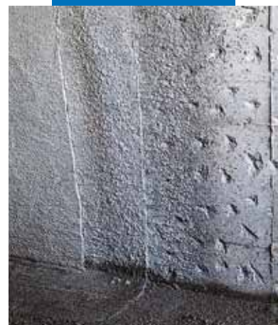
Fori di lavorazione della malta da intonaco additivata con Idrosilex
