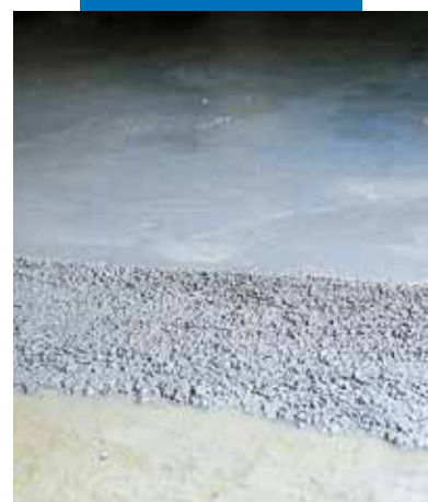
Massetto di sottofondo additivato con Idrosilex
