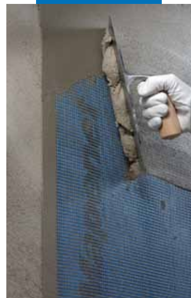
Applicazione del secondo strato di Planitop 200 con interposta Mapenet 150 su supporti di natura differente
