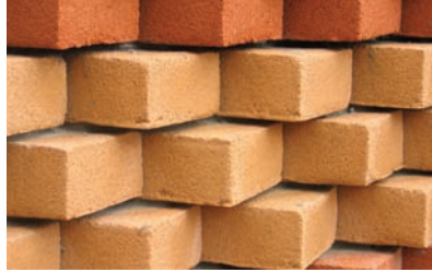
Particolare del rivestimento esterno dei muri costituito da una complessa e policroma trama di mattoni faccia a vista del tipo "a pasta molle" (Cantù, Mi).
