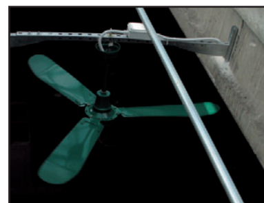
Il destratificatore di calore TWISTER viene fornito dalla ditta Basso Lucernari nella colorazione standard verde scuro.
