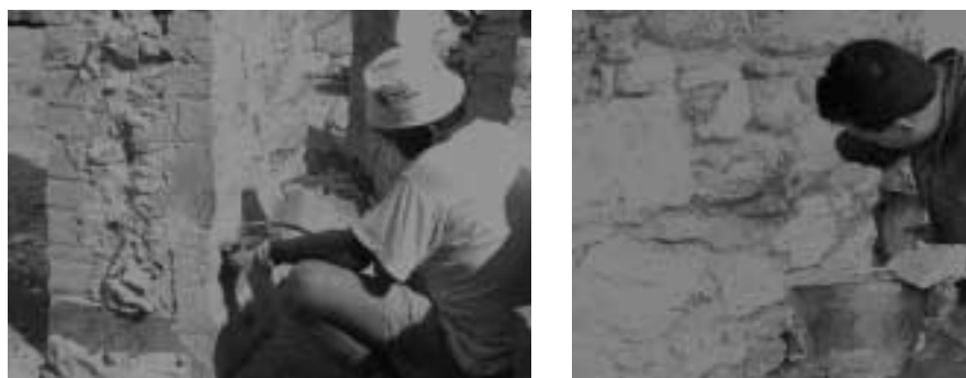
Fig. 9: Interventi di consolidamento su murature in pietra: iniezioni e ristilatura dei giunti (Valluzzi, 2000).
