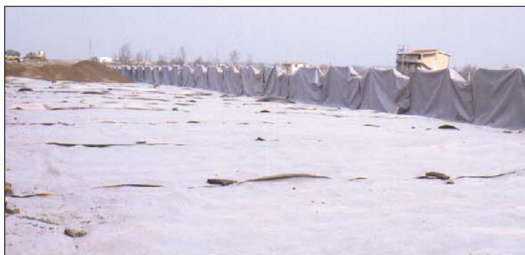
Scavo per la costruzione del rilevato compensato della terza corsia dell'autostrada Roma Civitavecchia.
