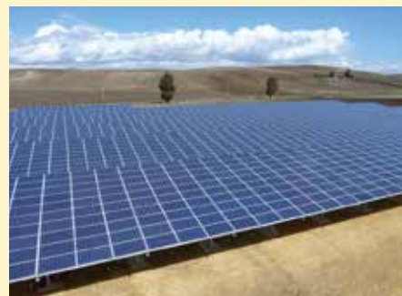
L'impianto fotovoltaico nello stabilimento di Enna.
