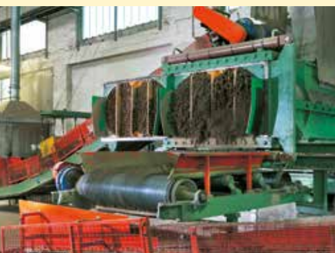
L'impianto di prelavazione argilla cruda.
