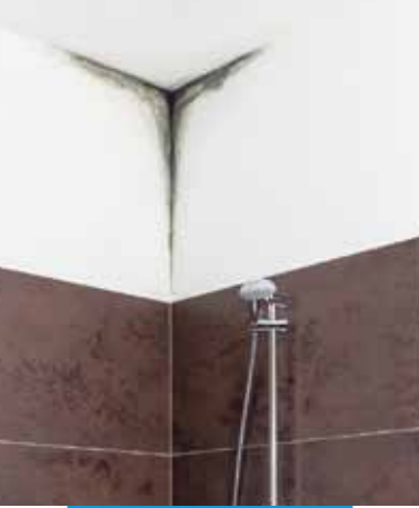
Superfici con evidenti problemi di muffa
